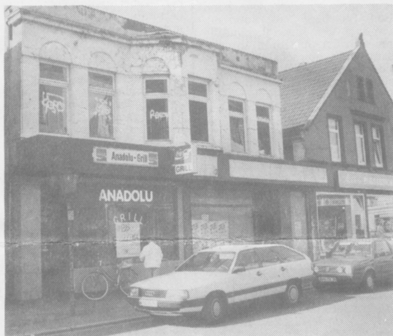
Baufällig ist dieses Haus Marktstraße 110. Die Stadt will es kaufen, abreißen lassen, damit auch hier neu gebaut werden kann. Im Augenblick ist das Haus ein Schandfleck. WZ-Fotos(3): Angst
